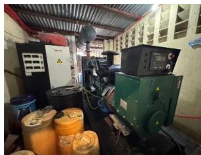
発電機・浄水室完備
